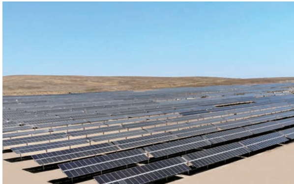
项目地: 哈萨克斯坦 容量: 150MW 解决方案: 天智2跟踪系统
